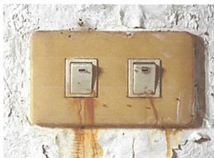
Foto 11: Sustrucción intrruptores dobles
