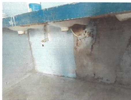
Foto 8: Sustrucción de mezcladora lavamanos (contra llave, tubo de abasto)
