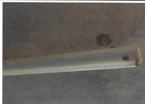
Foto 10: Sustrucción de plafoneras
