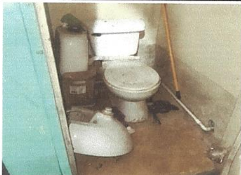
Foto 7: Sustrucción de inodoro
