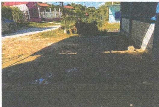
Foto 2: Sustrucción de piso de torta de concreto
