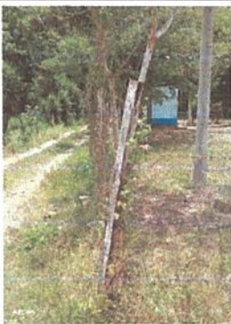
Foto: 4 SE PUEDE OBSERVAR LOS POSTES DEL CERCO TORCIDOS POR EL DETERIORO SUFRIÓ POR MÁS DE 20 AÑOS DE HABER CONSTRUÍDO EL CERCO.
