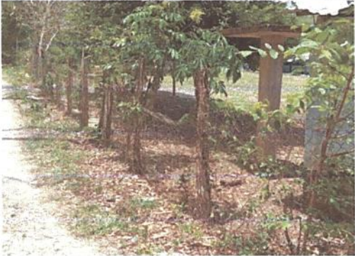
Foto: 3 PARTE DE ATRÁS DEL CERCO DEL PREDIO ESCOLAR SE PUEDE OBSERVAR QUE LA TELA ES MUY DETERIORADA.
