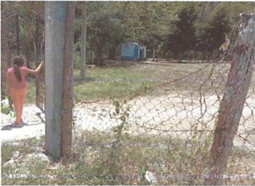
Foto 1: ENTRADA DEL PREDIO ESCOLAR, A UN COSTADO DEL POSTE DEL PORTON ESTA CAIDA LA MALLA METALICA LO CUAL GENERA INSEGURIDAD.
