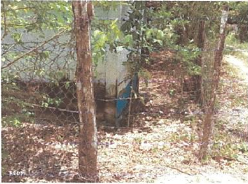
Foto 2: DETRÁS DE LOS BAÑOS ESCOLARES ESTA REMENDADO CON ALAMBRE DE PUAS EL CERCO DEBIDO AL DETERIORO DE LA MALLA METALICA LO CUAL GENERA INSEGURIDAD.
