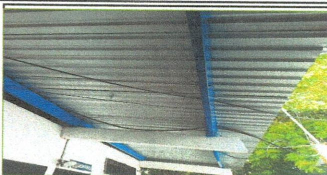
Foto No. 2: Vista por debajo de la instalación de laminas.
