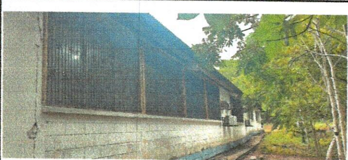
Foto # 05: Imagen del lado adverso de las aulas del ala #1 visible deterioro de techo.
