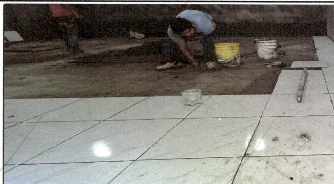
Foto 2: Sustrucción de piso cerámico
