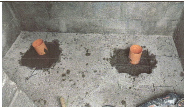
Foto 6: Sustrucción de Inodoro
