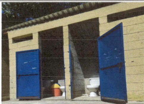
Foto 7: Sustrucción de inodoro
