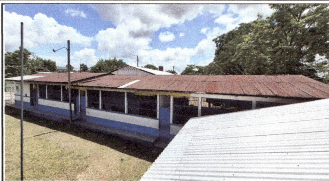
laminado en mal estado por su tiempo de servicio
