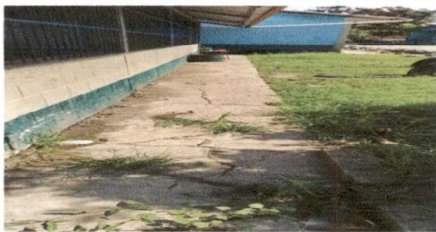
Foto 5: Sustrucción de piso de torta de concreto
