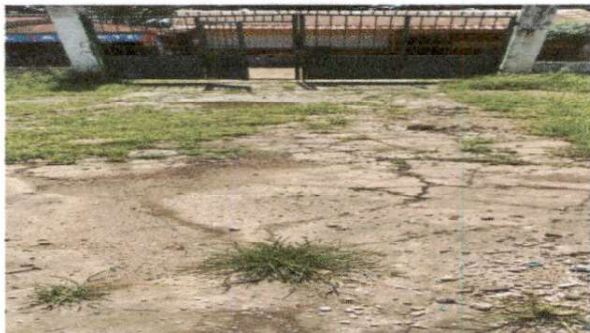
Foto1: Sustrucción de piso de torta de concreto
