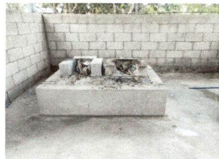
Foto 6: Mantenimiento a estufa rural
