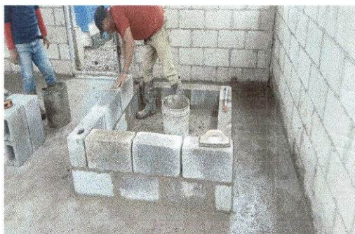
Foto 6: Mantenimiento a estufa rural
