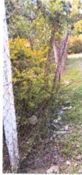
Foto 1: Inclinación de poste de madera y en mal estado.
