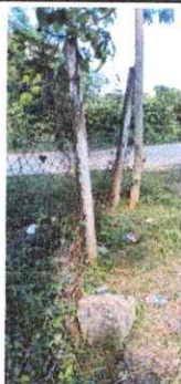
Foto 5: Malla perimetral en mal estado.
