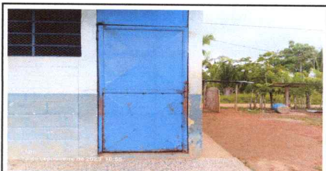
Foto 6: Sustrucción de puerta
