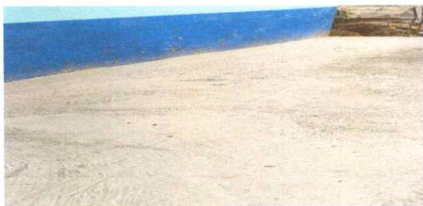
Foto 1: Piso de cocina
