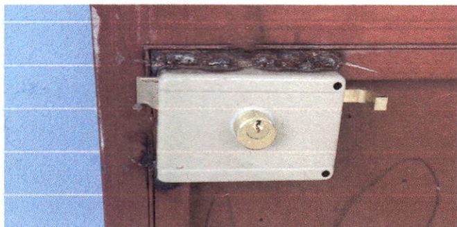
Foto 1: Sustrucción de chapa
