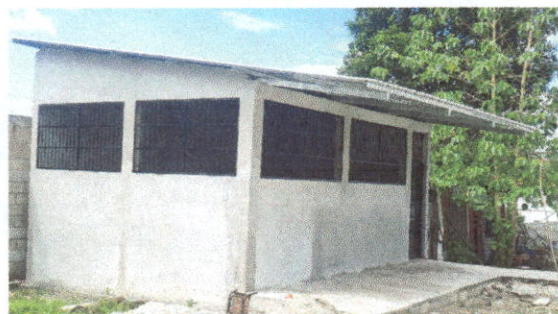
Foto 3: REPELO EN MURO
