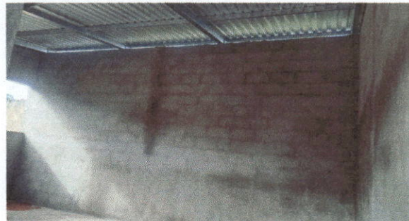
Foto 2: REPELO EN MURO
