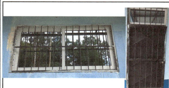
Foto 3: Sustrucción de estructura de metal por ventana de PVC
