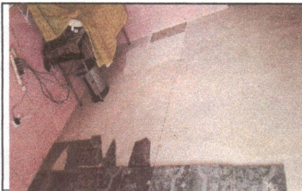
Foto: 3 Sustrucción de piso cerámico
