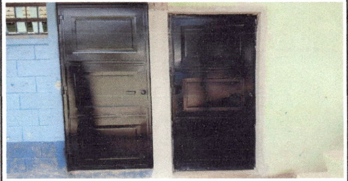
Foto 2: Sustrucción de puerta
