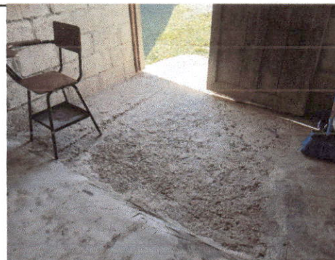
Foto 4: Sustrucción de piso de torta de concreto
