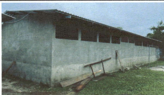
Foto 6: cernido en muros
