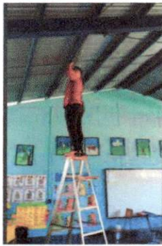
Foto 3: sustitucion de lamparas tipo led
