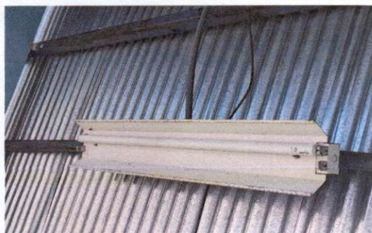
Foto: Sustitución de lámparas tipo Led
