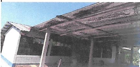
Foto 3: CAMBIO DE MADERA A METAL
