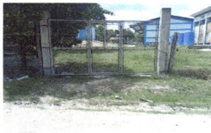
Foto: 5 Mantenimiento de porton aun pendiente a la fecha
