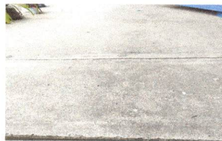
Foto 6: Sustrucción de piso de torta de concreto
