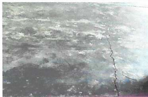
Foto 4: Sustrucción de piso cerámico
