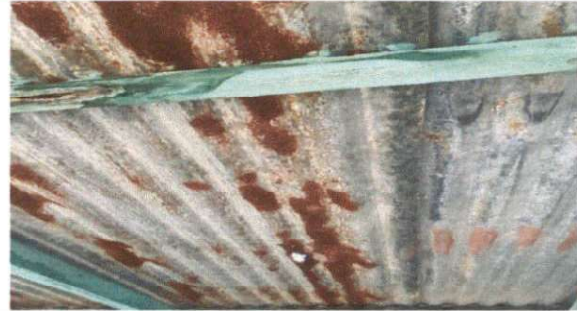
ESTRUCTURA DE TECHO DE MADERA POR METAL ✓
