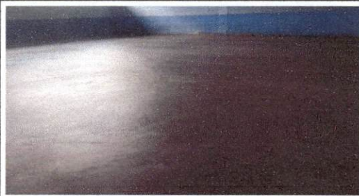
Foto 3: Sustrución de piso de torta de concreto
