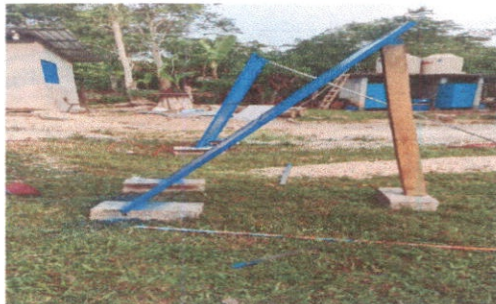
Foto 5: Sustrucción de puerta
