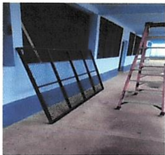
Foto 1: Sustrucción de estructura de metal de ventana
