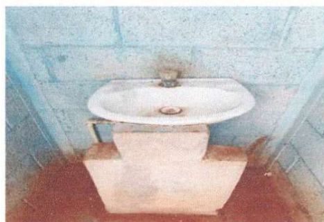
FOTO 2 Lavamanos en mal estado
