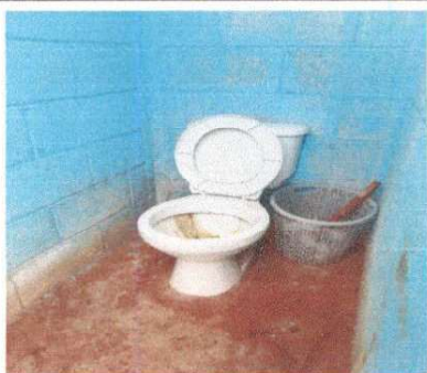
FOTO 1 Inodoros en mal estado
