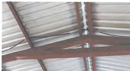
Foto 16: Sustrucción de ducto eléctrico + accesorios
