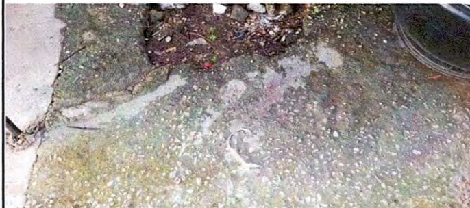
Foto 3: Sustrución de piso de torta de concreto
