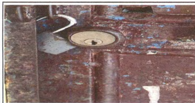
Foto 8: Sustrucción de chapa
