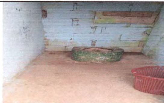
Foto 6: Sustrucción de inodoro
