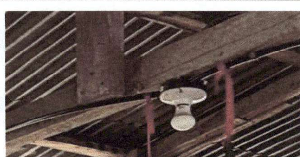
SUSTITUCION DE FOCOS AHORRADORES
