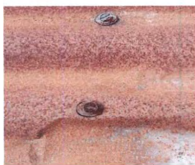
Foto 3: Sustrucción de elemento de fijación
