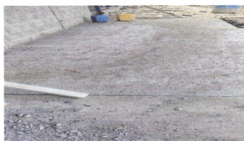
Foto 2: Sustrucción de piso de torta de concreto
