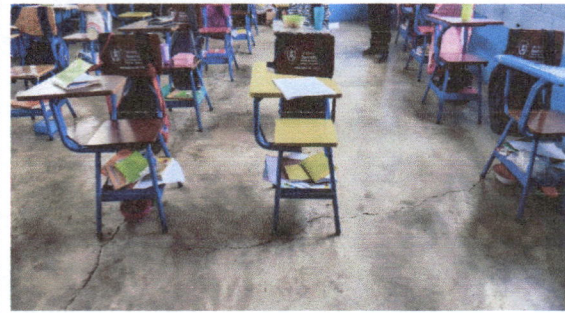
Foto 2: Sustrucción de piso de torta de concreto
