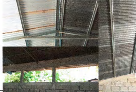
Foto 2: Láminas en mal estado (son dos aulas las que cuenta con láminas en mal estado).
