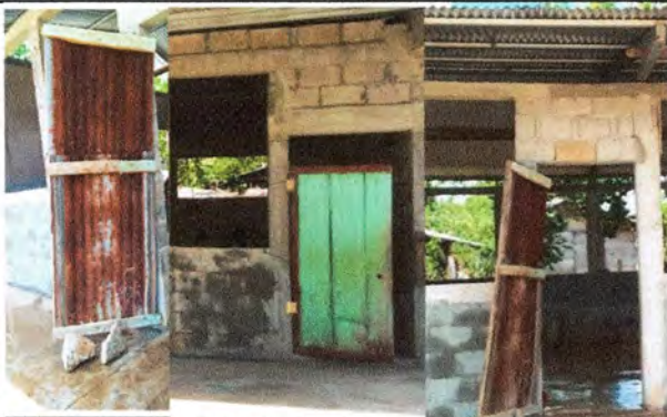
Foto: Puertas en mal estado, hechas de láminas y de madera (en total se requieren 4 puertas)
