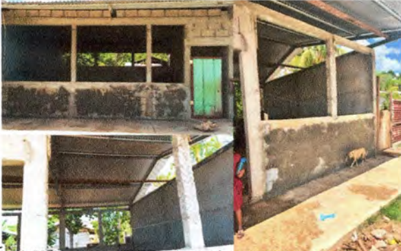
Foto 1: Malla en mal estado usada para las ventanas de cada aula escolar (En total son 3 aulas escolares que no tiene balcones).
