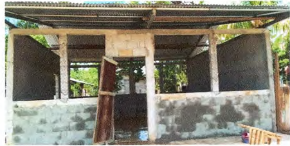
Foto: 4 Repellos en malas condiciones (se requiere el tallado y repello de los tres aulas)
