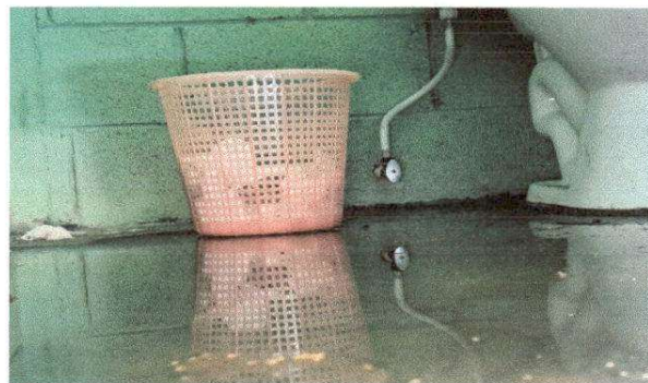
Foto 8: Sustrucción de accesorios en baños
