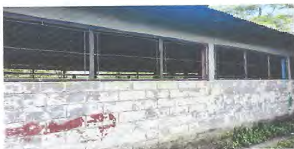
FOTO 7. PINTURA EN MURO EXTERIOR EINTERIOR
