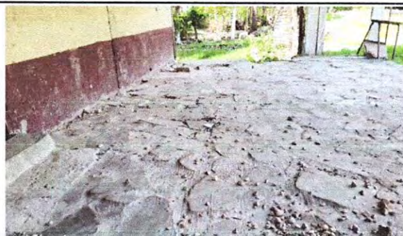
Foto 5: Sustrución de piso de torta de concreto
