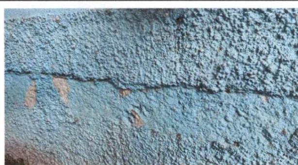
FOTO No. 2 REPELLO EN MURO
