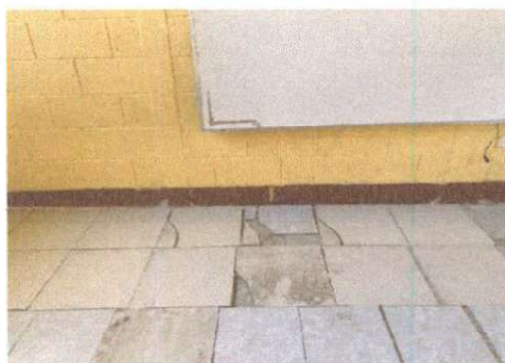
Foto 3: Sustrucción de piso cerámico
