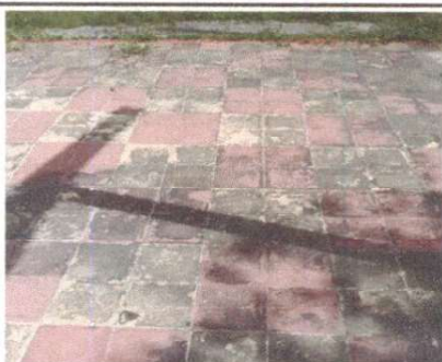
Foto 5: Sustrucción de piso cerámico
