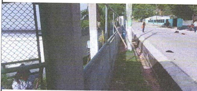
Muro perimetral de malla galvanizada
