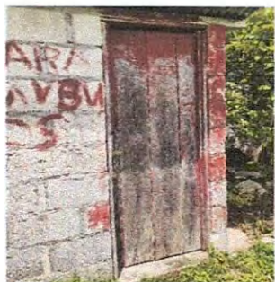
Foto 19: Cernido en muros
